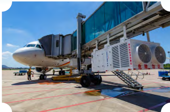
杭州机场 APU 替代设施
