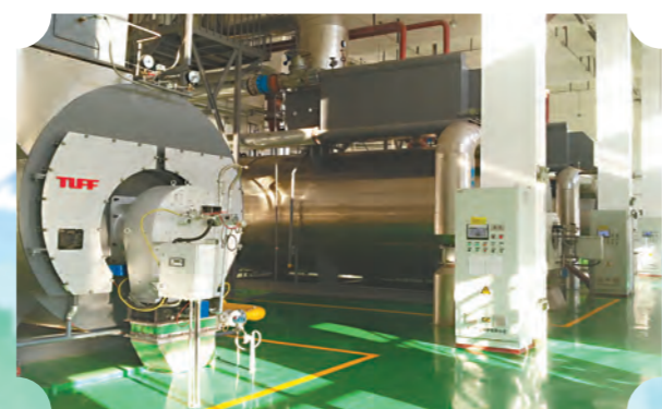
哈尔滨机场锅炉煤改气
