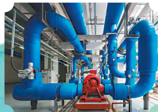
北京大兴机场地源热泵系统
