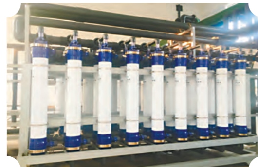
双流机场再生水回用厂超滤间
